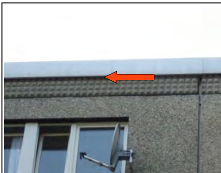
Abb. 45 - Drempeblech als Fledermausquartier (Finsternalder Str. 3, Eberswalde) 6
