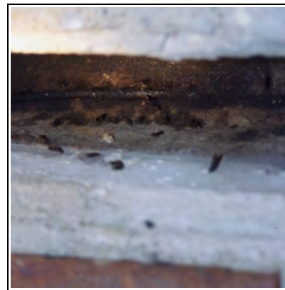
Abb. 9: Kotkrümel in einer Plattenbaufuge 4
