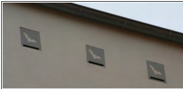
Abb. 32: In die Fassade integrierte vorgefertigte Fledermauskästen 4
