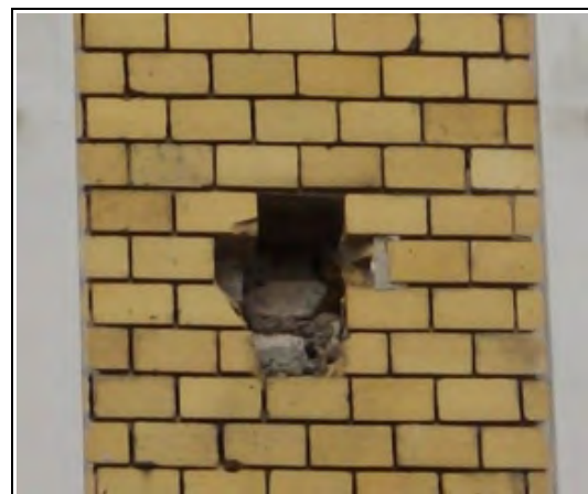
Abb. 31 - Mauerloch in Klinkerfassade (August-Bebel-Str. 10, Eberswalde) 6
