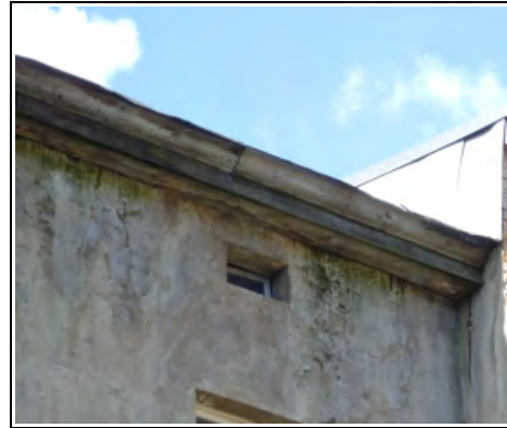
Abb. 29 - Quartier und Einflug zwischen Dachkasten und Fassade (Ruhlaer Str. 21, Eberswalde) 6
