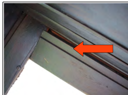
Abb. 26: Einflugspalte am Ortgangbrett (Fichtestr. 8, Eberswalde) 6
